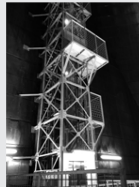
写真⑭ エレベーター
